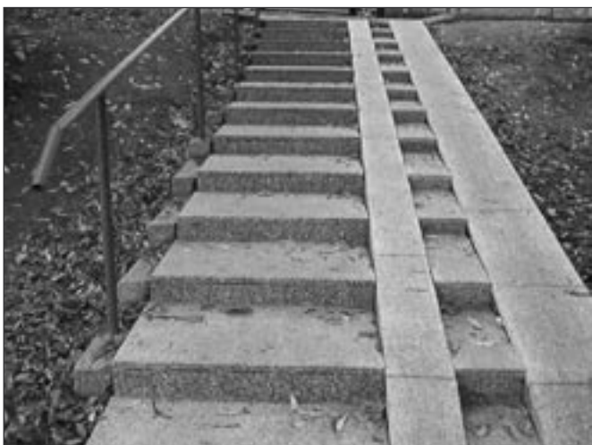
Nowe schody przy parku (ul. Andersa) - schody zostały obłożone materiałem kamiennym – teraz umożliwią bezpieczne dojście do placu zabaw.
