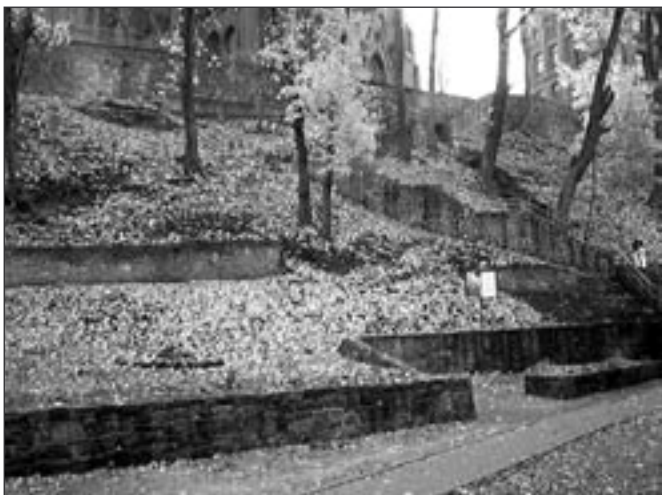
Budowa elementów małej architektury oraz wykonanie nasadzeń krzewów w parku przy ul. Fredry (skarpa przy Kościele Św. Mikołaja).
