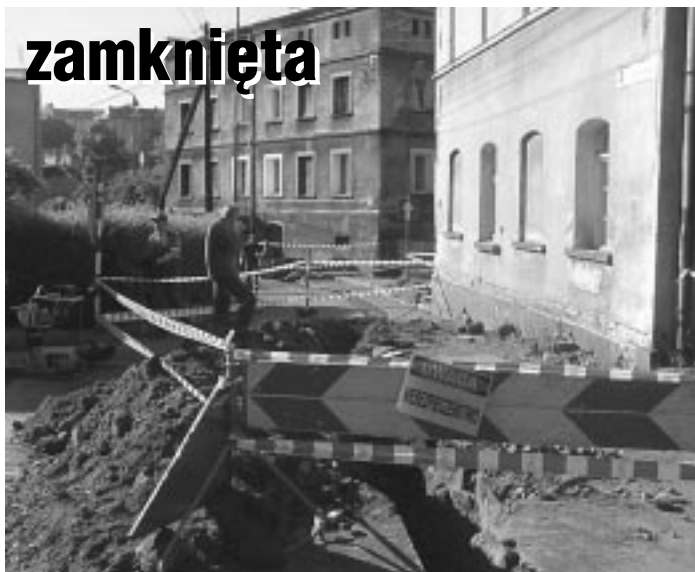
Zakład Wodociągów i Kanalizacji przeprowadzi w lipcu na ul. Wąskiej wymianę sieci kanalizacyjnej i przyłączy. W sierpniu natomiast ulica uzyska nową nawierzchnię z kostki granitowej. fot. W. Grzybowski
